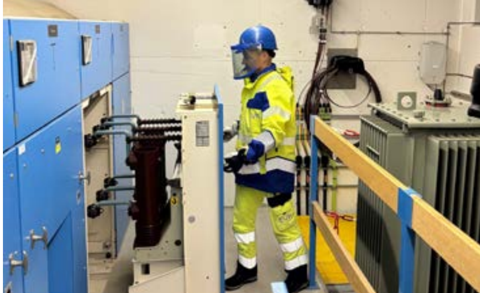
MS-Schalter TS Linthhaus
